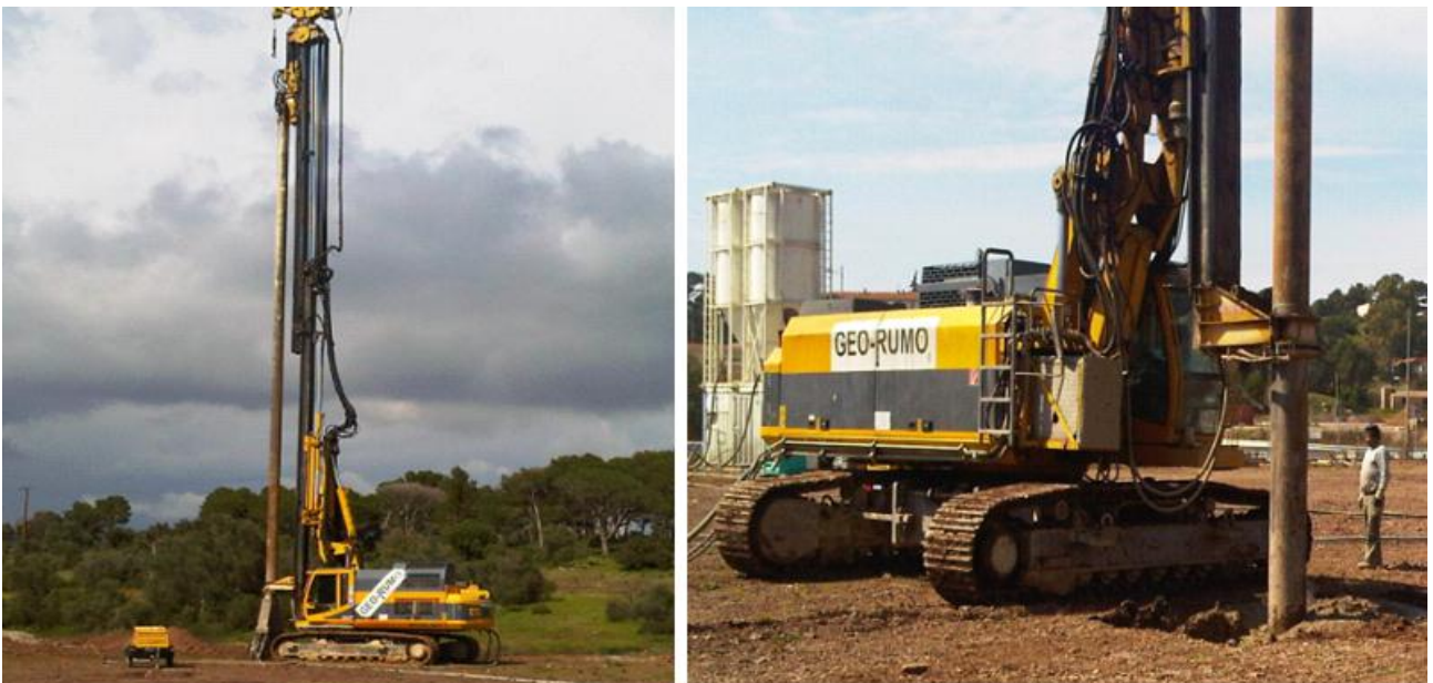
Figura 8 - Equipamento utilizado para a execução dos painéis de CSM
