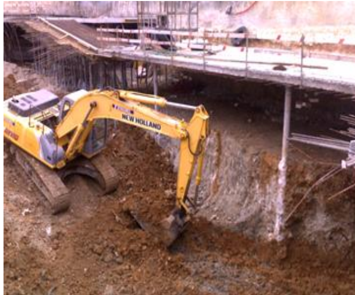
Figura 11 – Fotografia da obra durante a fase de escavação após a execução do 1º nível de travamento
