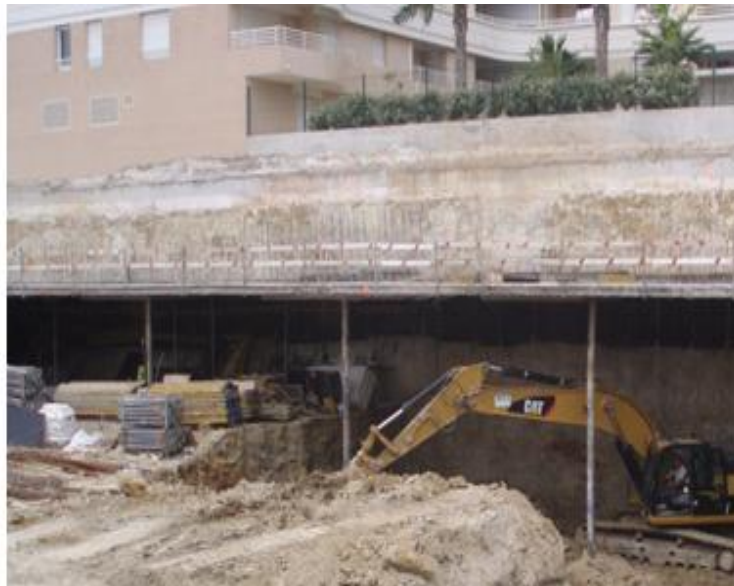
Figura 12 – Fotografia da obra durante a escavação abaixo do 1º nível de travamento
